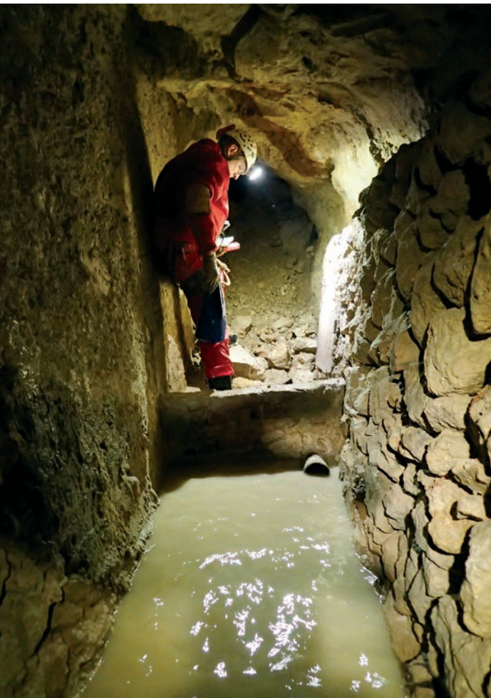
Galerie de drainage de la Grande Bastide Cazeaux au niveau du puits effondré, environ 76 m vers la sortie basse.
